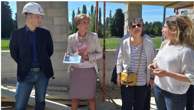
La maire d'Avignon, Cécile Helle, a officiellement posé la première pierre du chantier de l'école des Olivades, vendredi 10 mai. © Radio France - Elsa Vande Wiele
